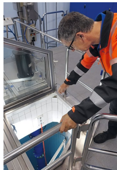
Martin Hunziker in seinem verborgenen Reich der Trinkwasserversorgung.
