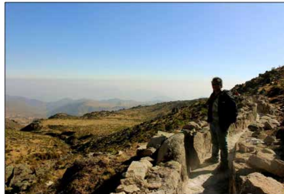
FIGURA 7 - 7CANAL REVESTIDO PARA GARANTIZAR LA INFILTRACIÓN DEL AGUA EN LAS ZONAS DE INFILTRACIÓN (FUENTE: INVESTIGACIÓN MAMANTEO, CONDESAN 2015)
